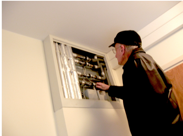
John Lasén kontrollerar huvudkran och vattenmätare till en av lägenheterna.
