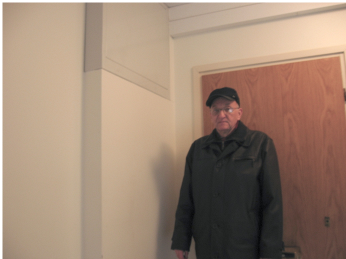
Disponent John Lasén i trapphuset på Skolhusgatan 20 vid de nya inkapslade stigarna.
